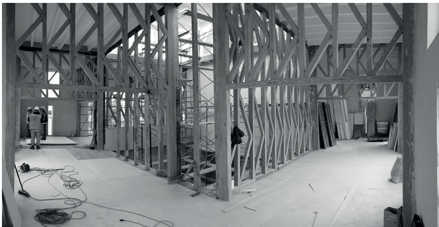
Figura 06. Desmontabilidad de los muros de la segunda planta. Vista de los pies derechos
