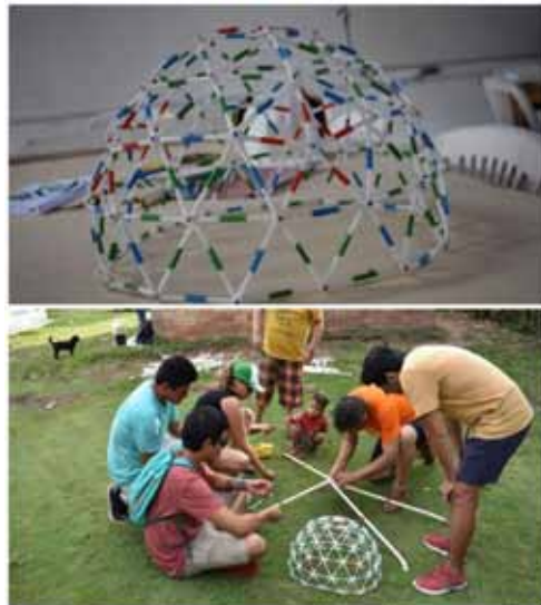
Figura 16 y 17. Modelo a escala 1/10, a utilizar como guía de trabajo, inicio del montaje en obra, uniendo los 5 primeros tubos en torno a un perno y tuerca siguiendo el modelo a escala.
