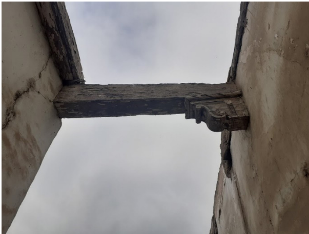
Figura 9. Detalle de viga de madera con inclusión de ménsula, sobre pasaje. Fuente: archivo personal (27.11.2019).
