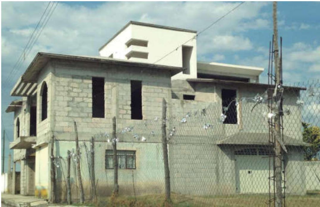
Figura 8. Ampliación de la vivienda con remesas, San Simeón. Fuente propia, visita a la localidad, abril 2017.
