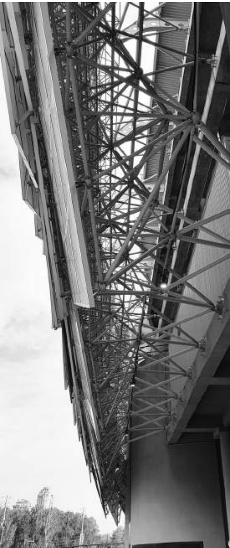
Figura 35. Spartak Stadium de Moscú. Vista de la estructura metálica que soporta la envolvente diagonal. Foto: C. Castañeda, 2018.
