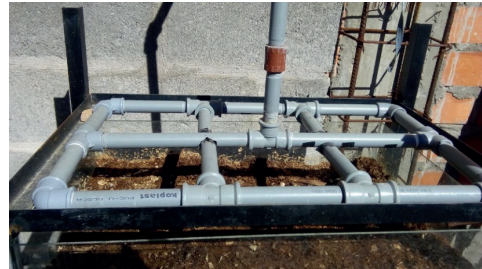
Figura 2. Sistema de goteo / lombrifiltro.
