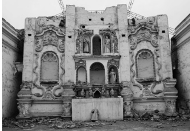
Fig. 6 Departamento de Lima. Retablo mayor de la capilla perteneciente a la antigua hacienda Larán, en la provincia de Chíncha. La capilla carece de techumbre y el retablo en obra de yesería está seriamente afectado. Es uno de los pocos ejemplos con ornamentaciones rococó en la costa central del Perú. Imagen: Sandra Negro, 2017
