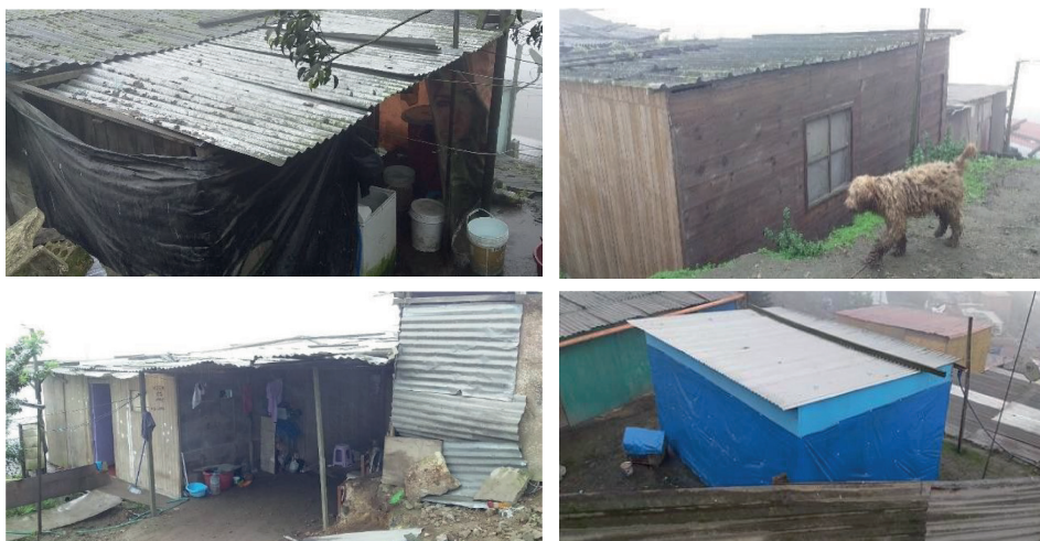
FIGURA 7. Fotos del estado actual de algunos de los techos de cuatro viviendas que conforman la muestra. Fuente: Elaboración propia
